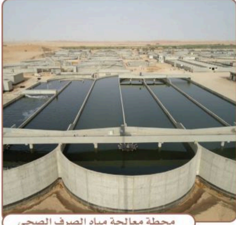
محطة معالجة مياه الصرف الصحي
